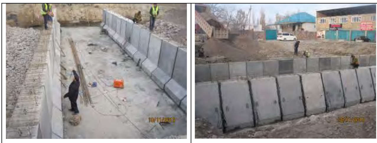
Рисунок 45. Нарушения техники безопасности при строительстве моста на канале Жантай
