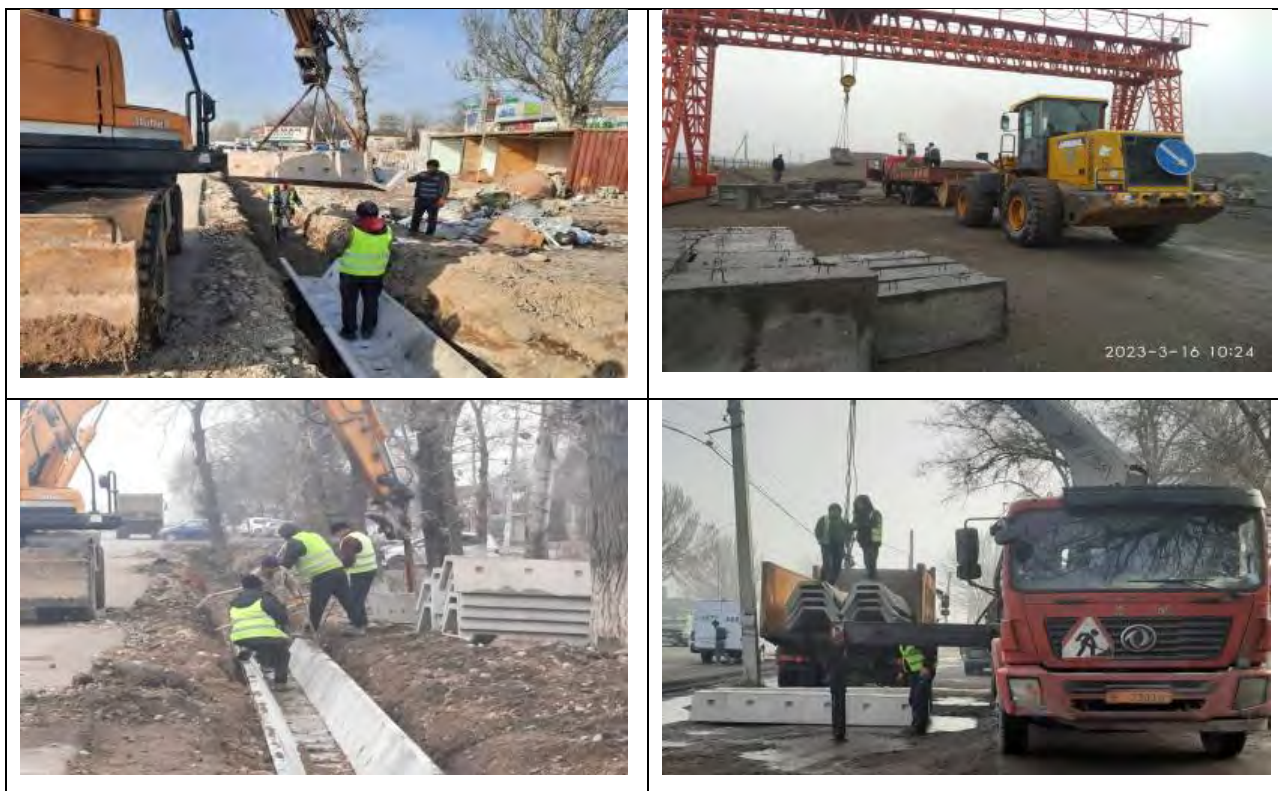
Рисунок 67 Несоблюдение техники безопасности при перемещении грузов подъемным краном
