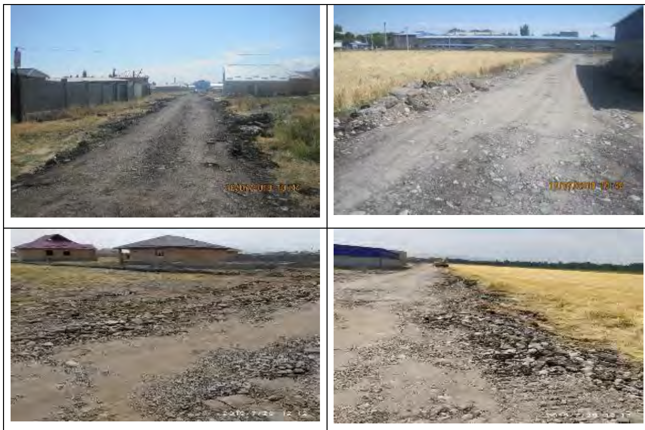
Рисунок 28 Вывоз старого асфальта на территорию жилмассива «Ынтымак» по просьбе жителей и представителей мэрии г. Шопоков
