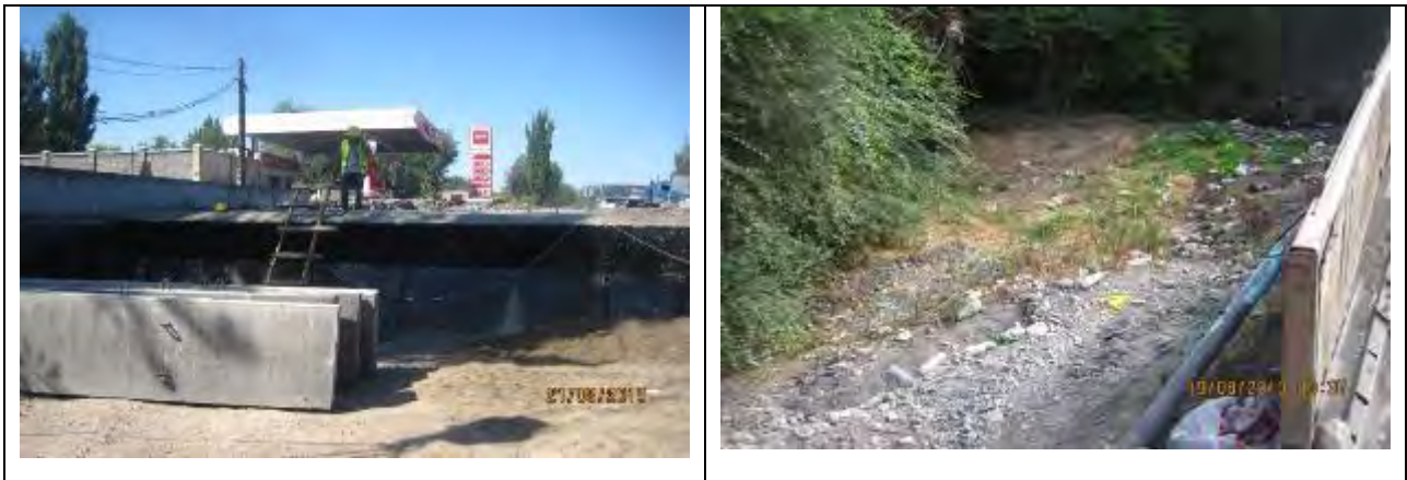
Рисунок 47 Нарушения техники безопасности при строительстве моста на канале Крепостной
