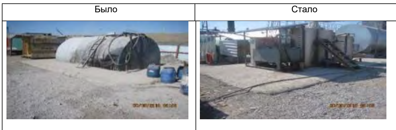
Рисунок 51 Непроницаемое защитное покрытие вокруг емкостей с химическими растворами
