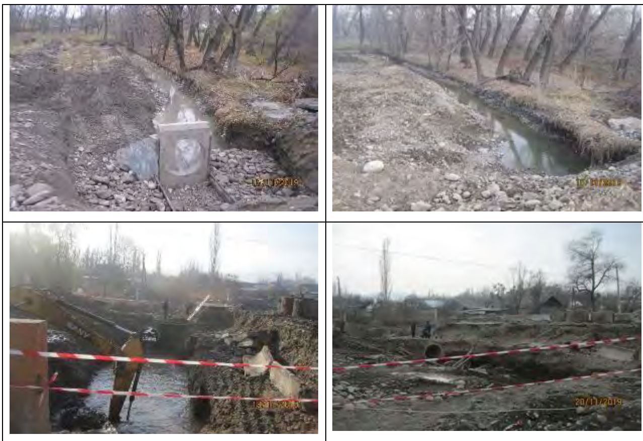
Рисунок 52 Выклинивание грунтовых вод при строительстве водопропускных труб
